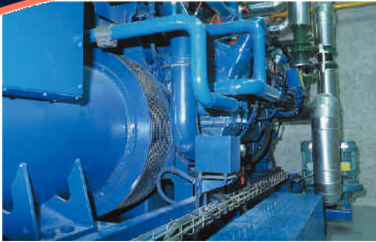
Exemplu (Centrala Termica)
